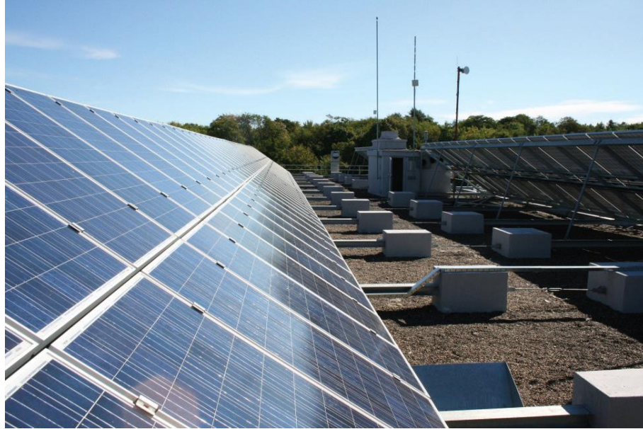
Slika 7.3. Fotonaponska elektrana na krovu zgrade Instituta „Mihajlo Pupin” [138]
